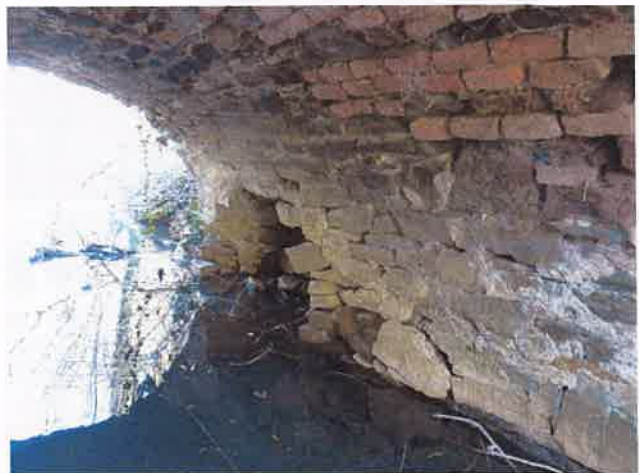
Pohled na opěru 2. Rozpadlá opěra na výtoku.
