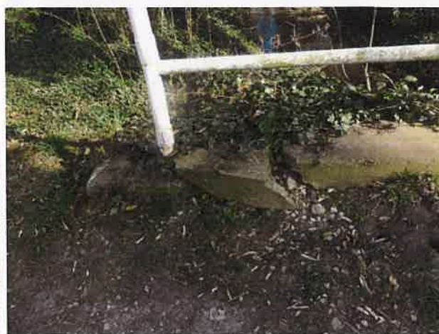
Popraskaná levá římsa
