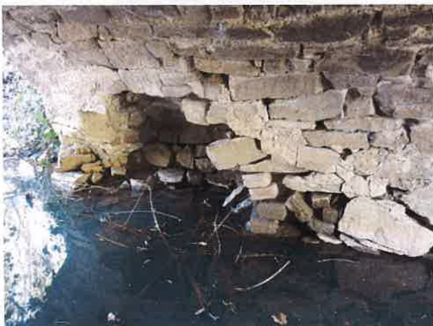
Rozpadlá opěra 2 na výtoku. Chybí zdivo na dl. 1,30 m, v. 0,80 m, hl. 0,60 m.
