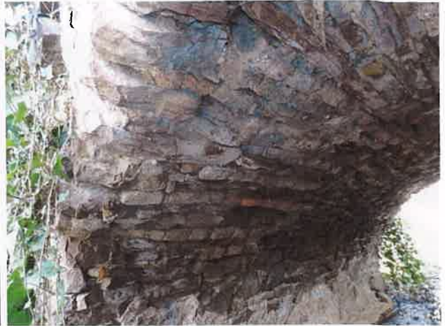
Detail zdiva klenby – zvětralé kameny i cihly
