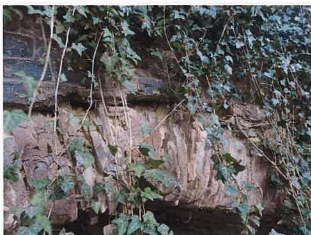
Pravá čelní zeď a čelo klenby – detail. Zvětralé kameny na čele klenby, vysouvá se čelní zeď.
