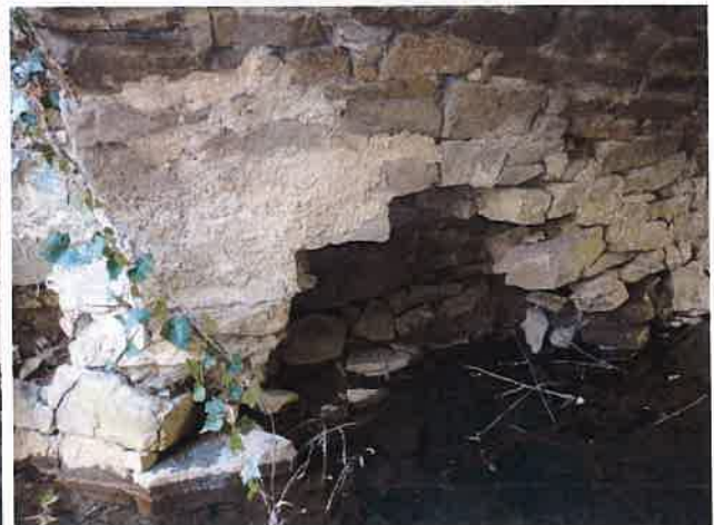
dtto – detail Také navazující zdivo je rozvolněné – hrozí další rozpad při velké vodě.
