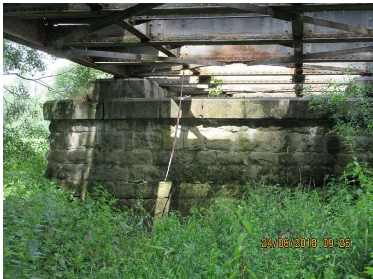
Povrchová koroze hlavního I-nosníku i příčníků.
