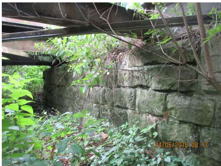
Popraskané a místy vypadlé spárování mezi kameny.
