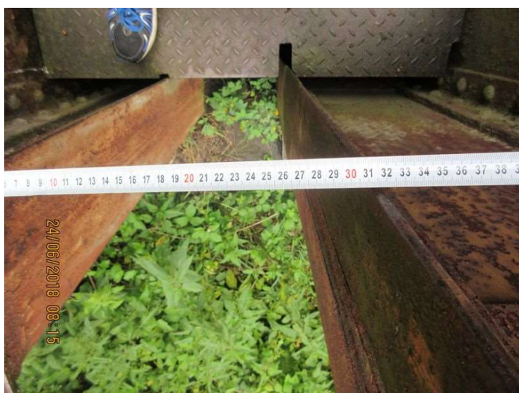
Otvor mezi zábradlím na pravé straně.
