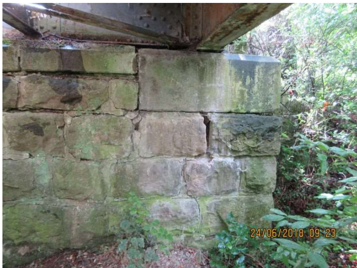
Trhliny ve spárování mezi kameny.
