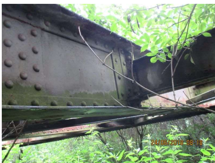
Povrchová koroze I-nosníků a příčniců.
