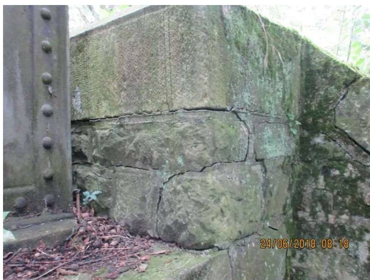
Popraskané spárování na závěrné zídce.
