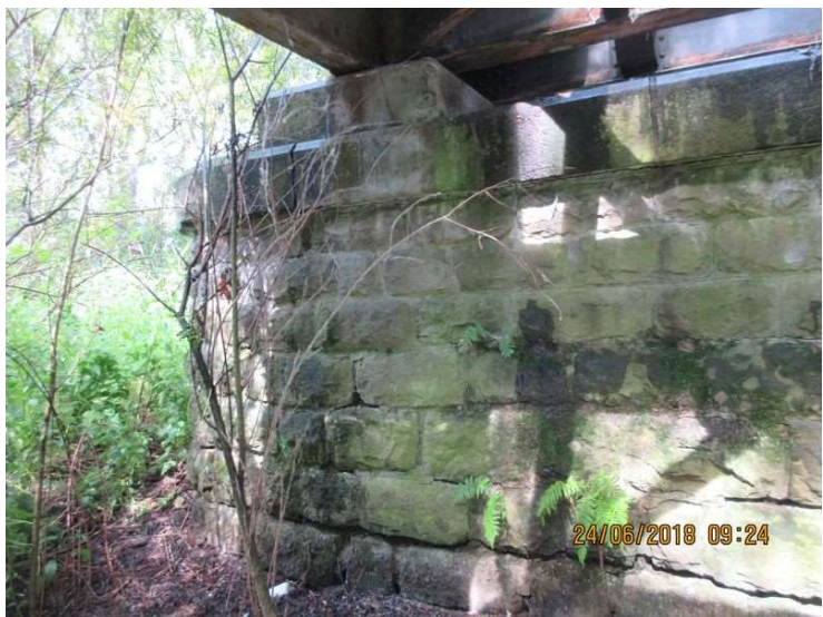
Vypadané spárování mezi kameny.
