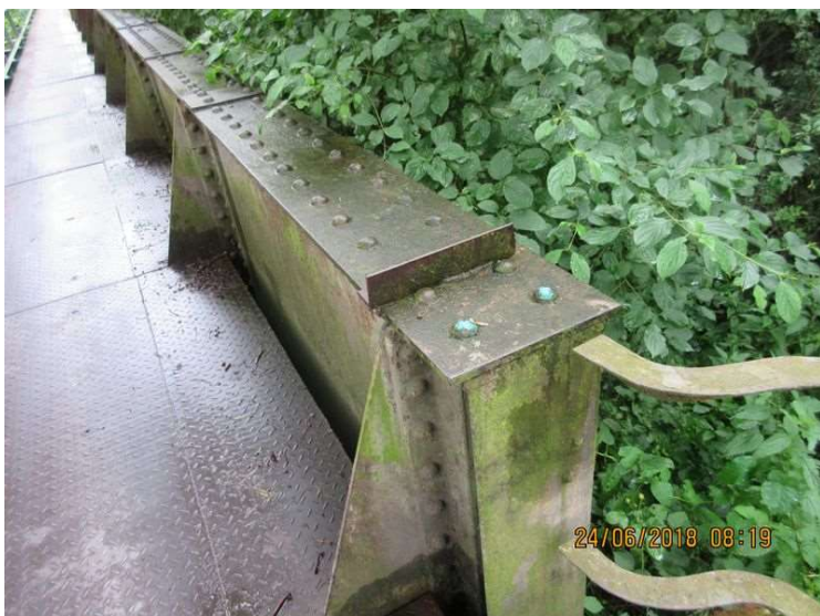
Ostrý roh na pravém zábradlí.
