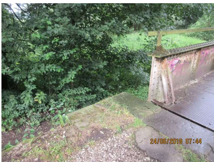
Chybí zábradlí na křídle u OP2
