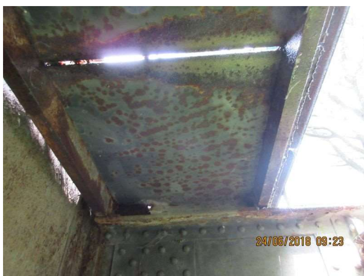
Povrchová koroze pohledu pochůzích plechů.
