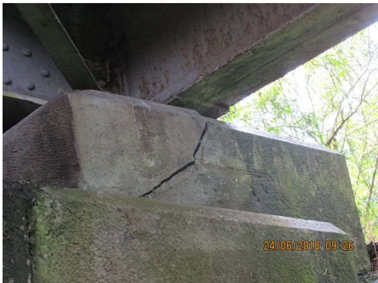
Prasklý blok pod uložením NK.
