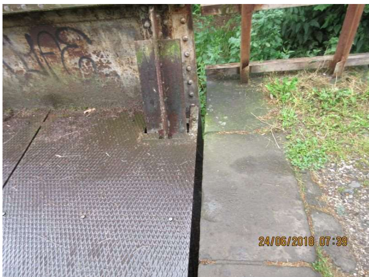
Dilatační spára mezi NK a závěrnou zídou.
