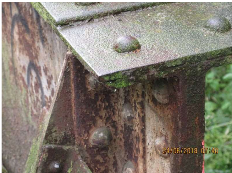
Ostrý roh na pravém zábradlí.
