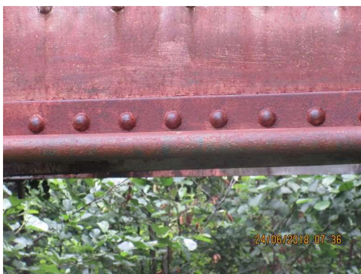
Povrchová koroze I-nosníků.
