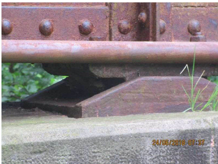
Povrchová koroze ložisek
