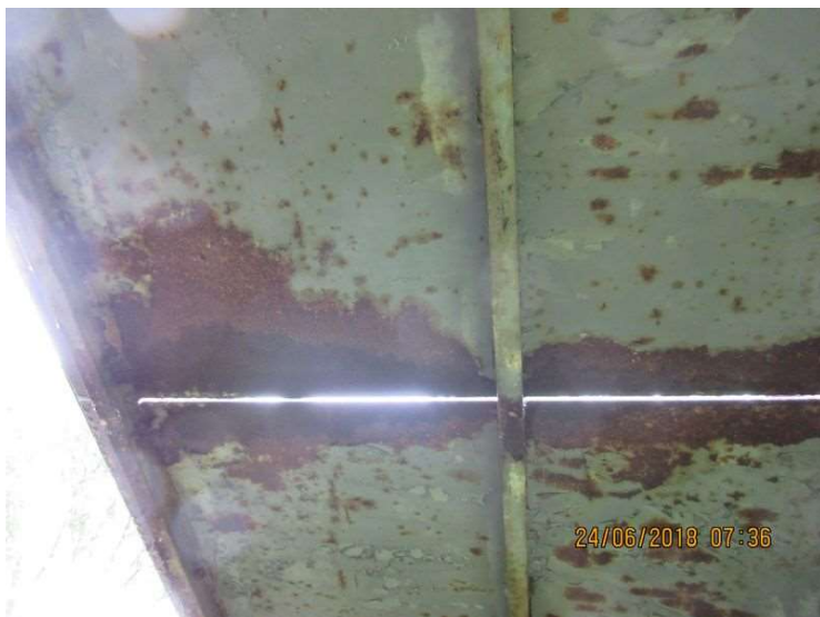
Podhled chodníku – ocelová mostovka. Koroze spodní části pochozích plechů.
