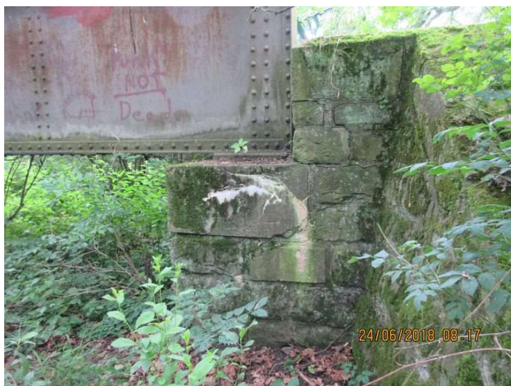
Trhliny ve spárování mezi kameny. Koroze plechů uložení NK.
