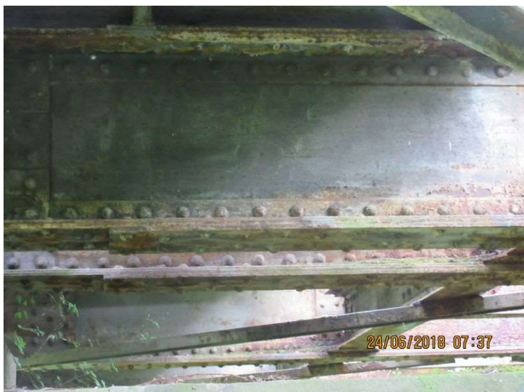
Podhled mostu – koroze příčníků.
