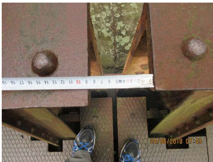
Otvor mezi zábradlím na pravé straně.
