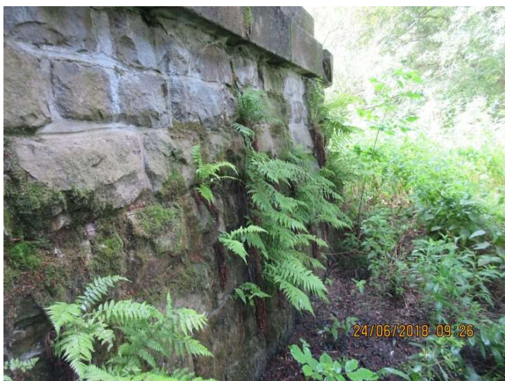
Vegetace ve spárách pilířů
