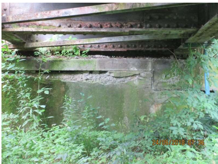
Popraskané opěry pod úložným prahem. Drolí se beton.
