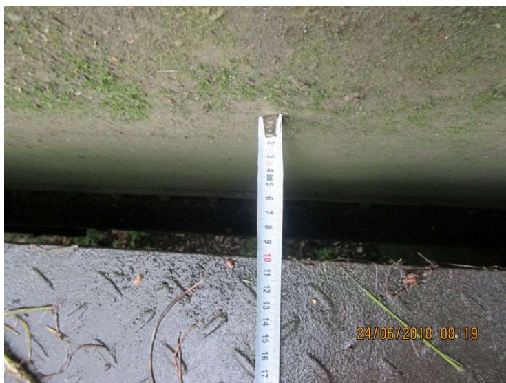
Díra mezi nosníkem a pochůzím plechem.
