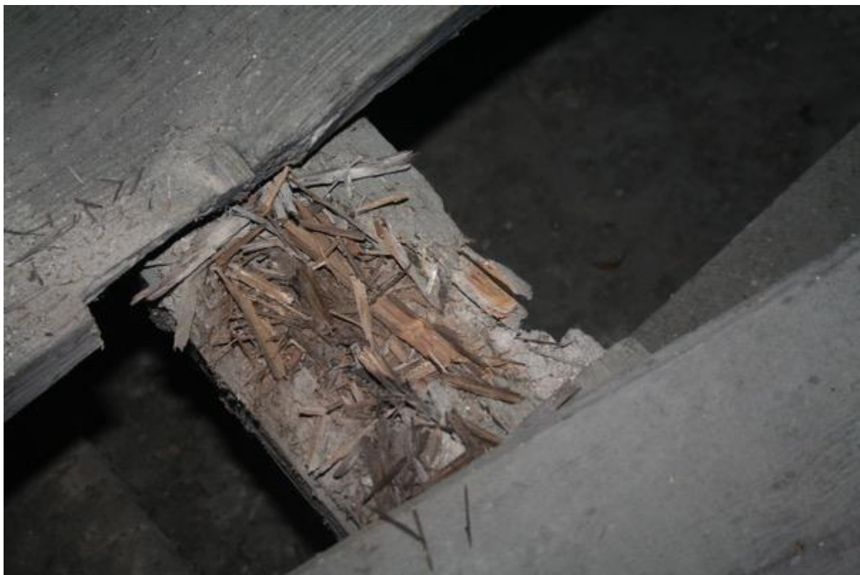
foto č. 13 degradace trámu
