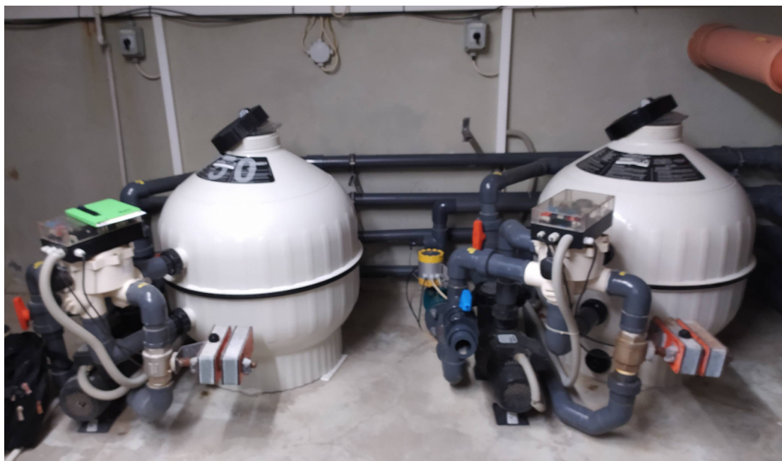
^ stávající zařízení úpravy vody pro krytý plavecký bazén ve Studénce
