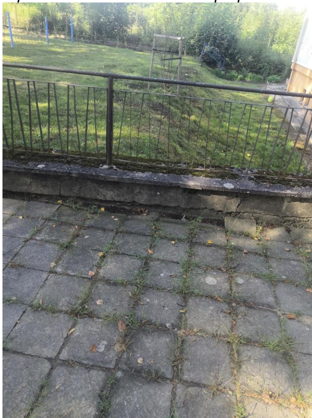
foto č.1. Opěrná stěna se zábradlím a propadlá dlažba terasy
