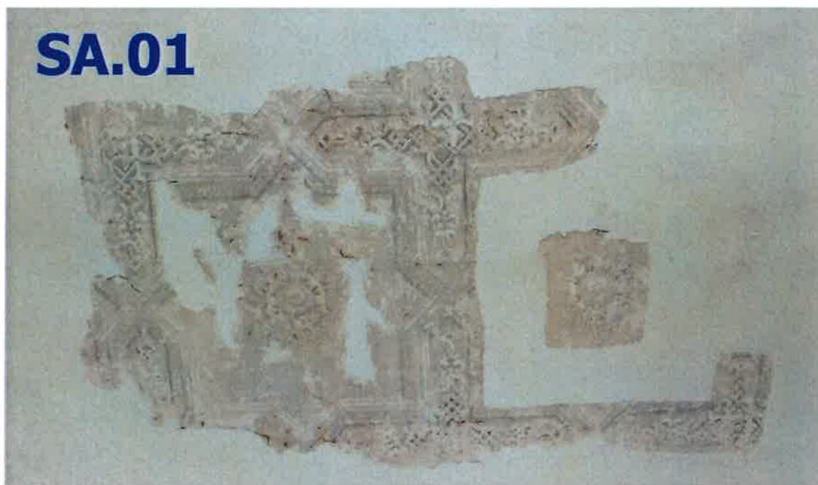
Sonda SA.1 Část odhaleného iluzivního malovaného kazetového stropu
