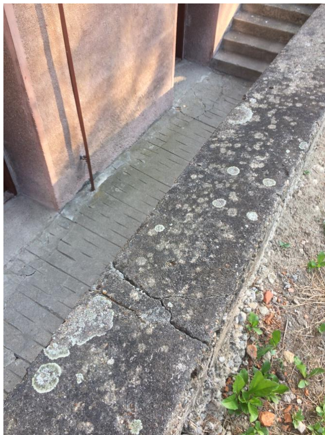
foto č. 4 pukliny v zídce
