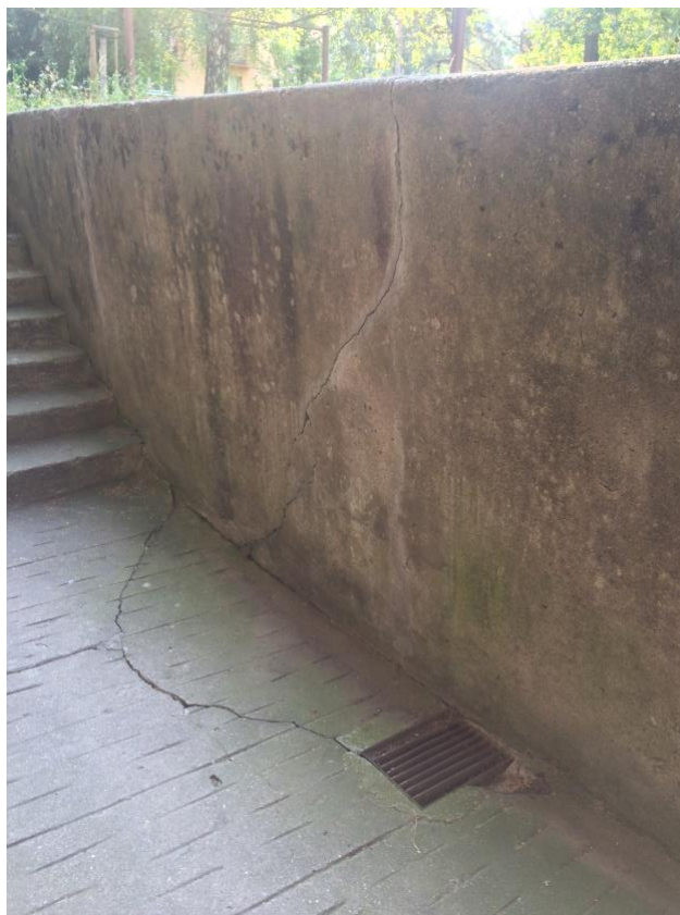
foto č. 2 pukliny
