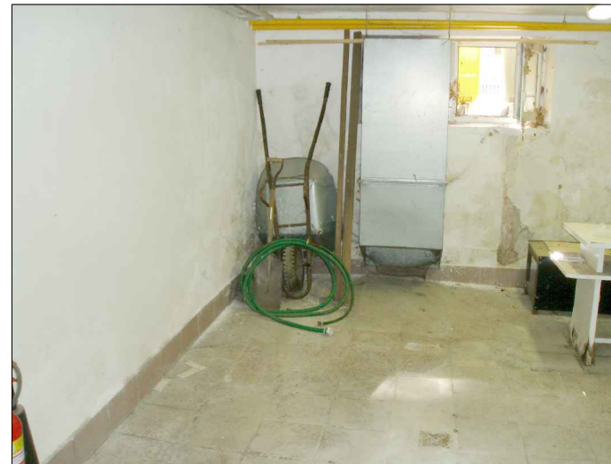
VNITŘNÍ PROSTOR KOTELNY
